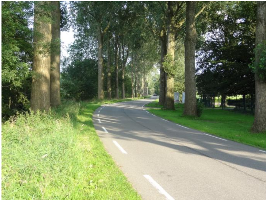
Ook aan de Koaibosk is geen sprake van schade door wortelopdruk
